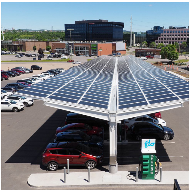
Ombrières solaires à Québec
